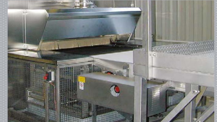
Installations de transformation de légumes grillés, surgelés ou en conserve dans l'huile
